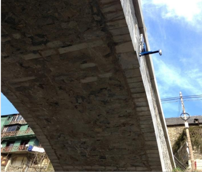
Estación de Sensores SmartyRiver400 sobre el puente de Aubèrt.
