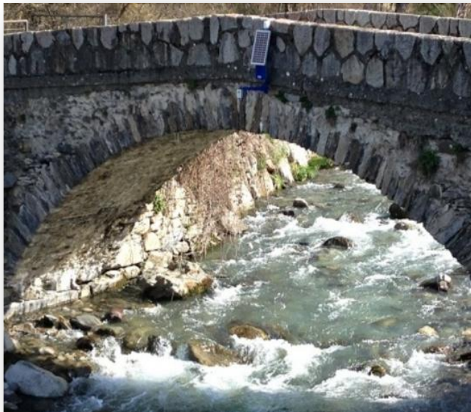
Estación de Sensores SmartyRiver400 sobre el puente de Escunhau antes de la avenida.
